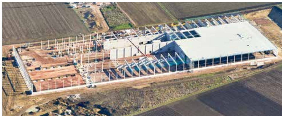
Schneller, genauer und flexibler arbeiten : dank einer Kombi aus MTS-NAVI und MTS-Bodenrecycler.
