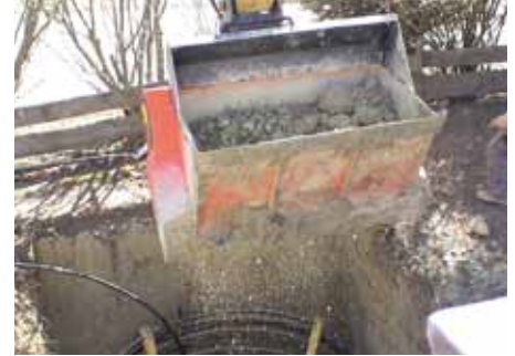
Aufbereitung des bindigen Bodens mit einer ALLU DN 217 25 mm zur Ummantelung der Erdkollektoren
