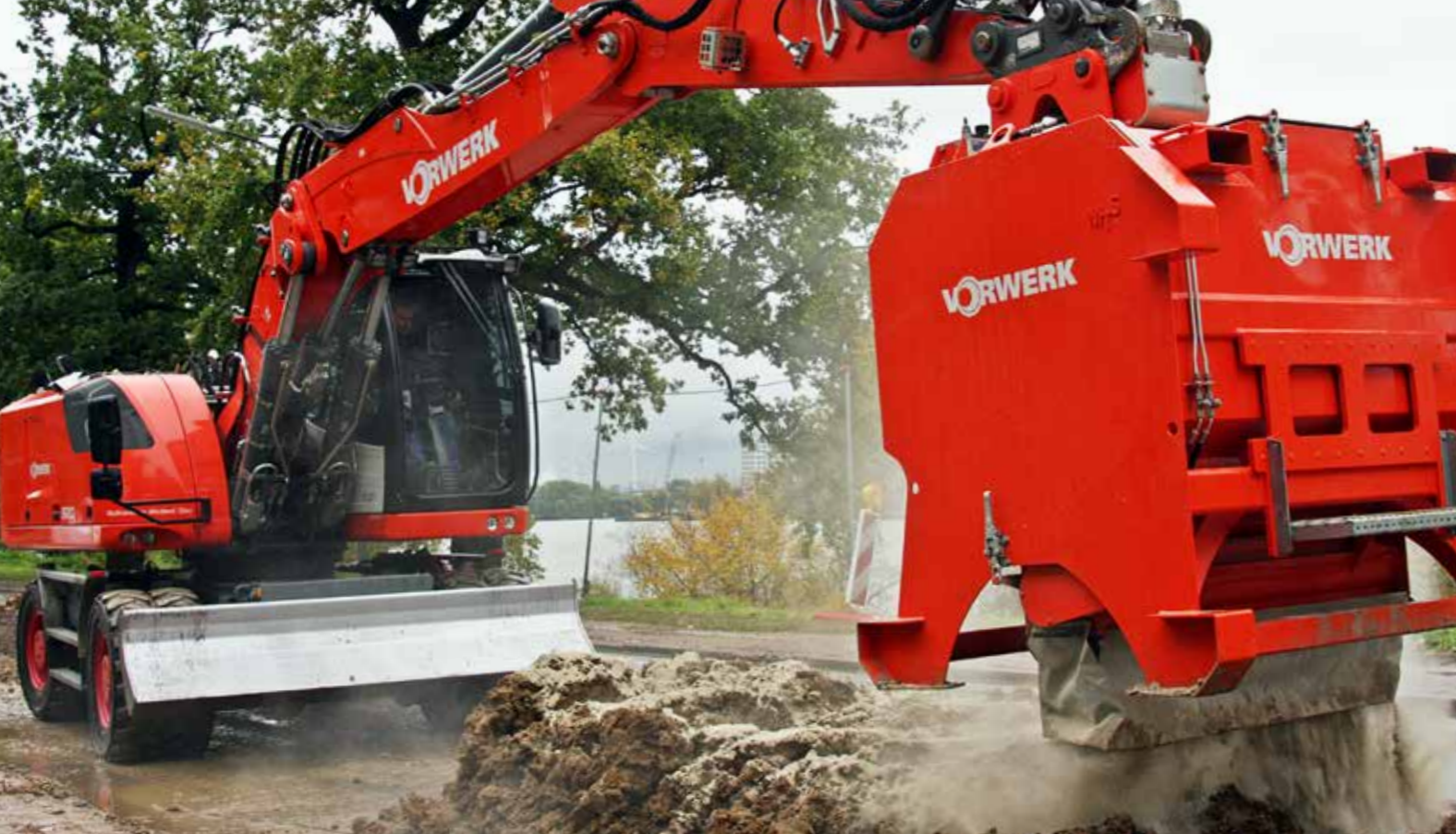
Dank Einsatz des e.p.m Verfahrens konnte sich die Firma Vorwerk allein bei dieser Baustelle den Abtransport von 14.000 cm 3 Boden sparen.
