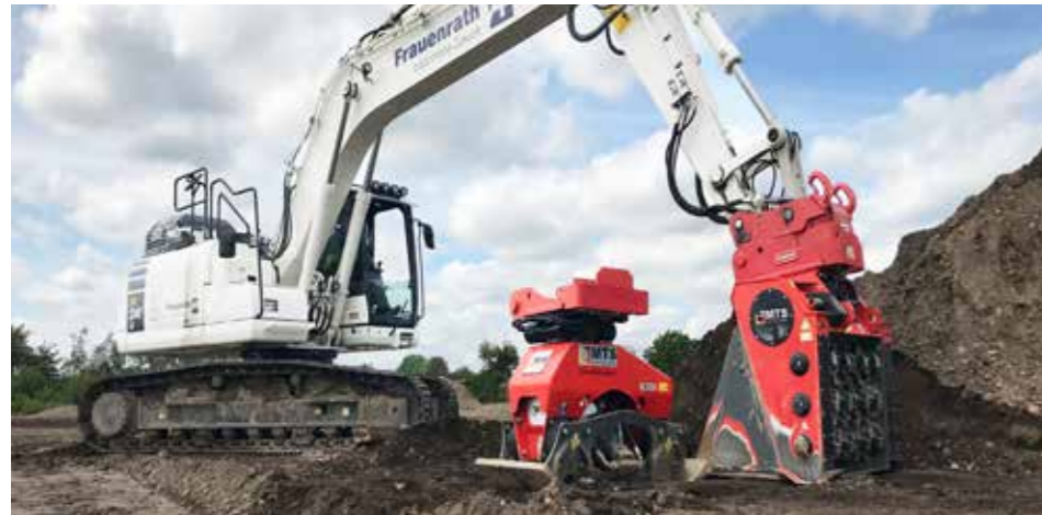
Die Frauenrath Bauunternehmen GmbH setzt beim Tiefenabbruch auf ressourcenschonendes MTS-Bodenaufbereitungsverfahren. Hier bei Einweisung und Ersteininsatz zur Bodenaufbereitung beim Trainingszentrum Dynamo Dresden.
